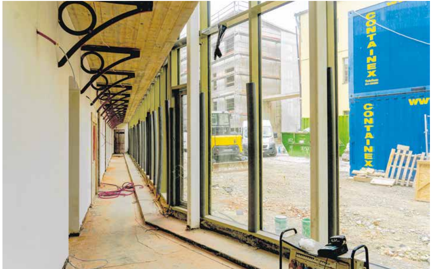
Közel 4000 négyzetméteren alakítják ki a papréti műemléki környezetben a Darazsak Sportakadémia kampuszát. Az épületben az előadótermek, tanulószobák mellett például kollégium és sportmenza is helyet kap. FOTÓ: FILEP ISTVÁN
